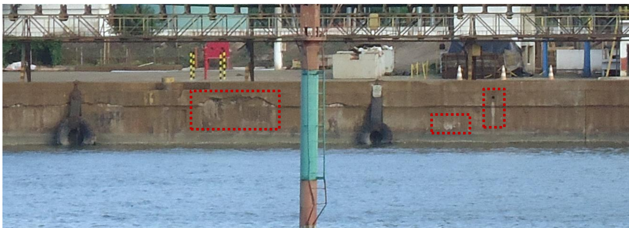
Carbonatação observada nos berços 206 e 905.
